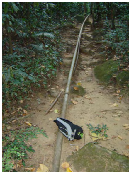
Foto 11 - Detalhe da tubulação, em P19 – P20
