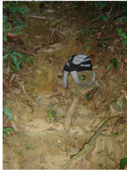
Foto 14 - Trecho erodido no acesso ao Poço Preguiça, entre P25 e P25.
