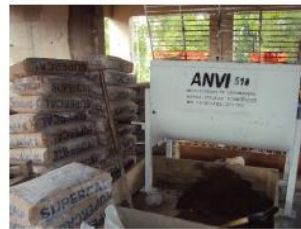
Figura 4 – Central de dosagem de argamassa
