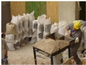
Figura 2 – Central de dosagem de areia
