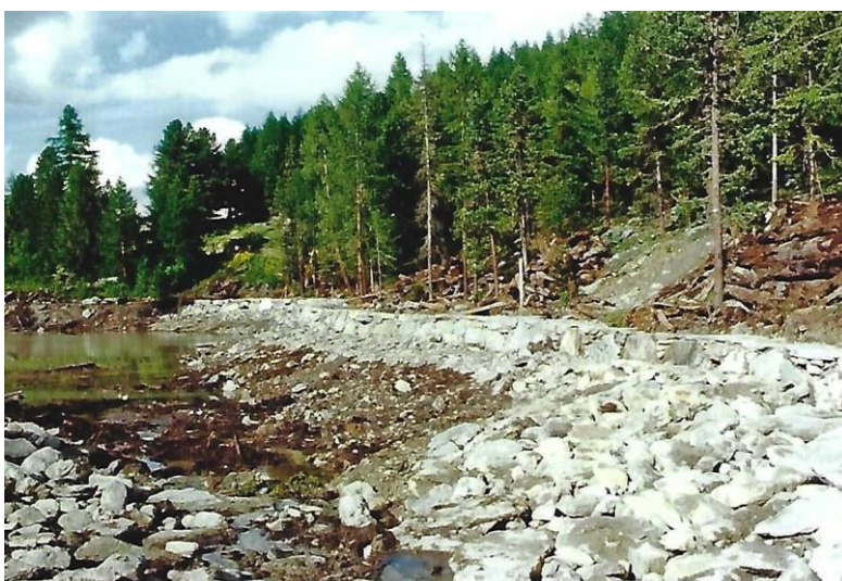
Abb. 7 Der See ist fast komplett entleert. Die Arbeiten sind in vollem Gange. (Foto: Ernst Schär)
