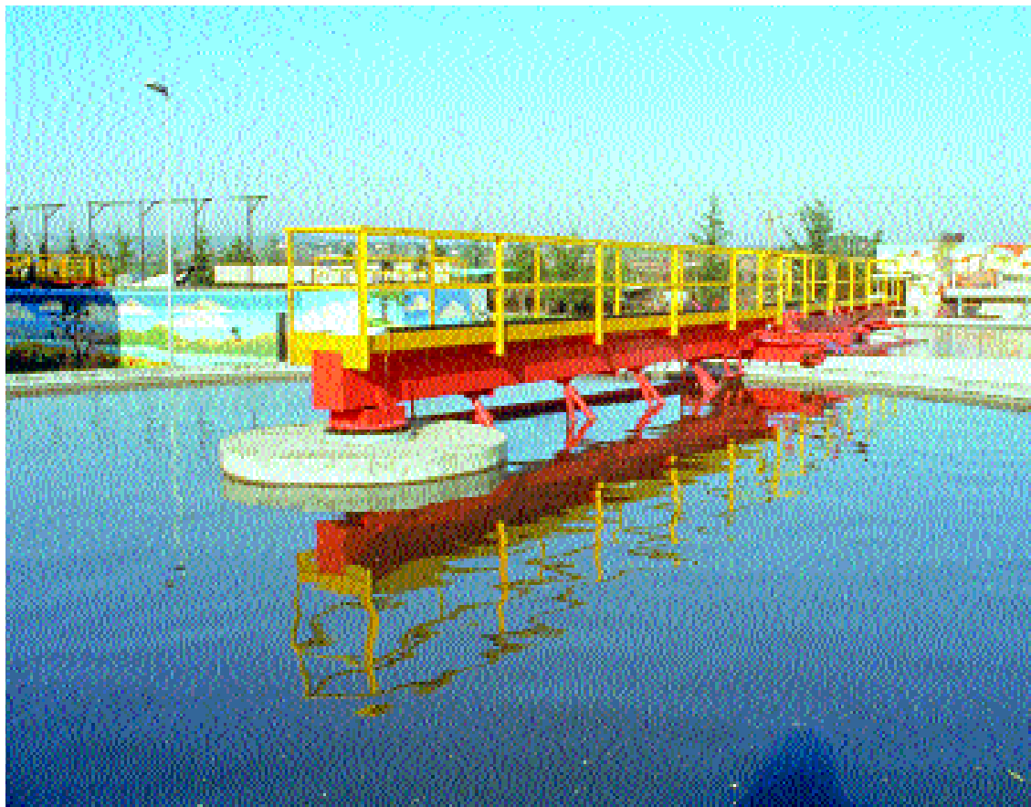
Impianto di depurazione per la tutela del lago di Bracciano
