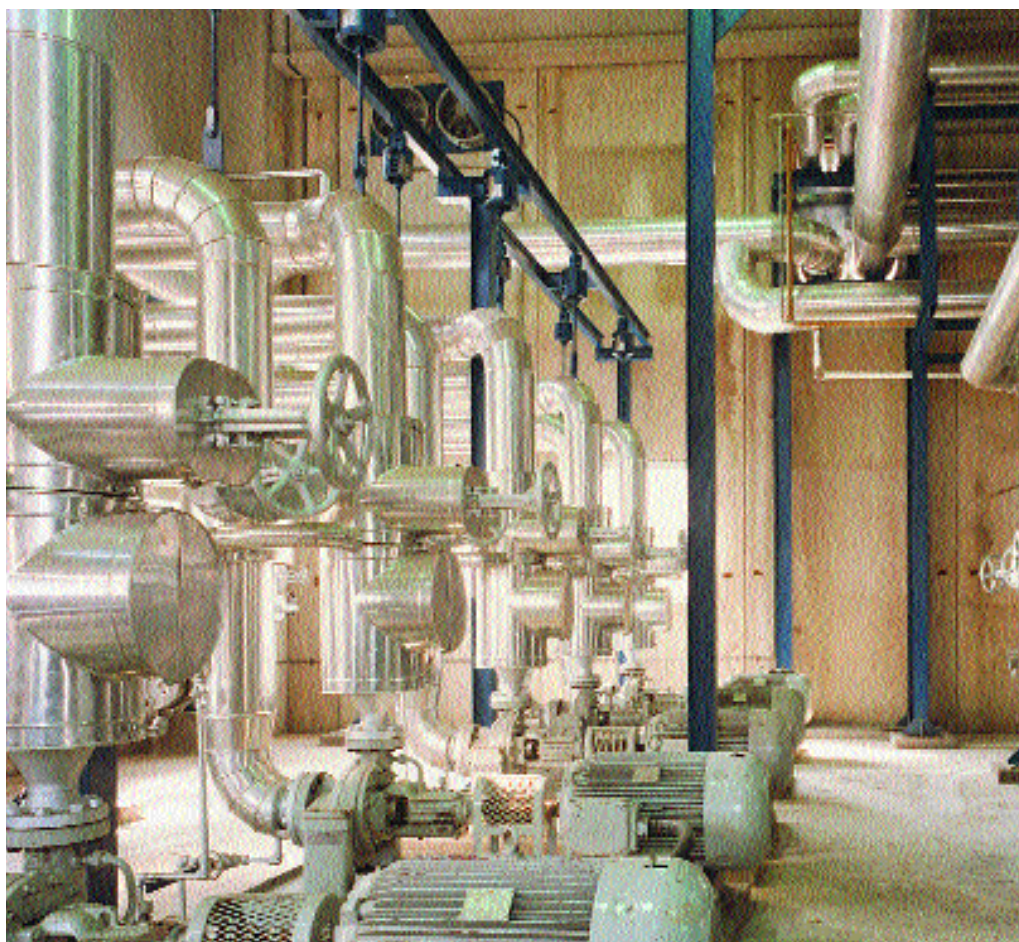
Interno della 1 a sezione della vecchia Centrale Tor di Valle
