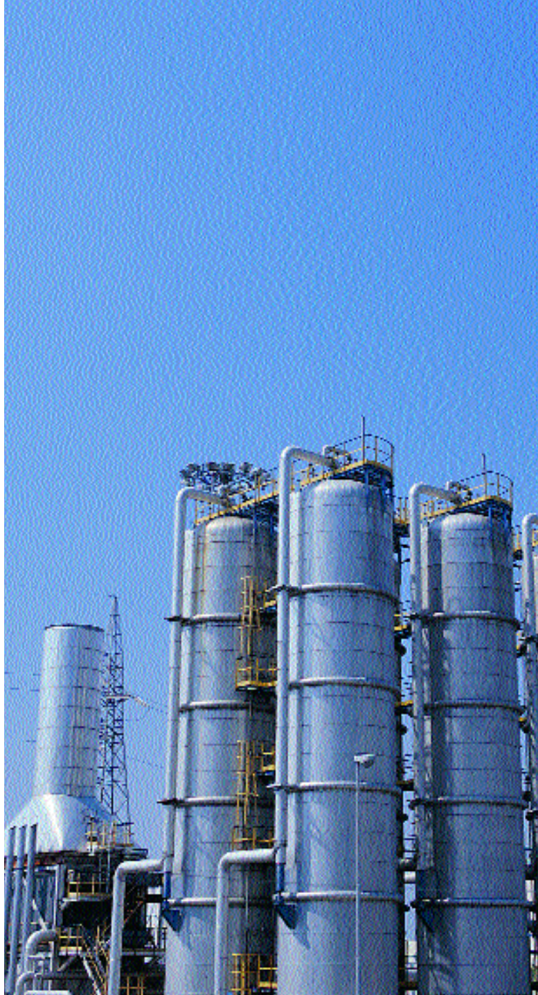
La Centrale di Cogenerazione Tor di Valle: i serbatoi di accumulo di acqua calda
