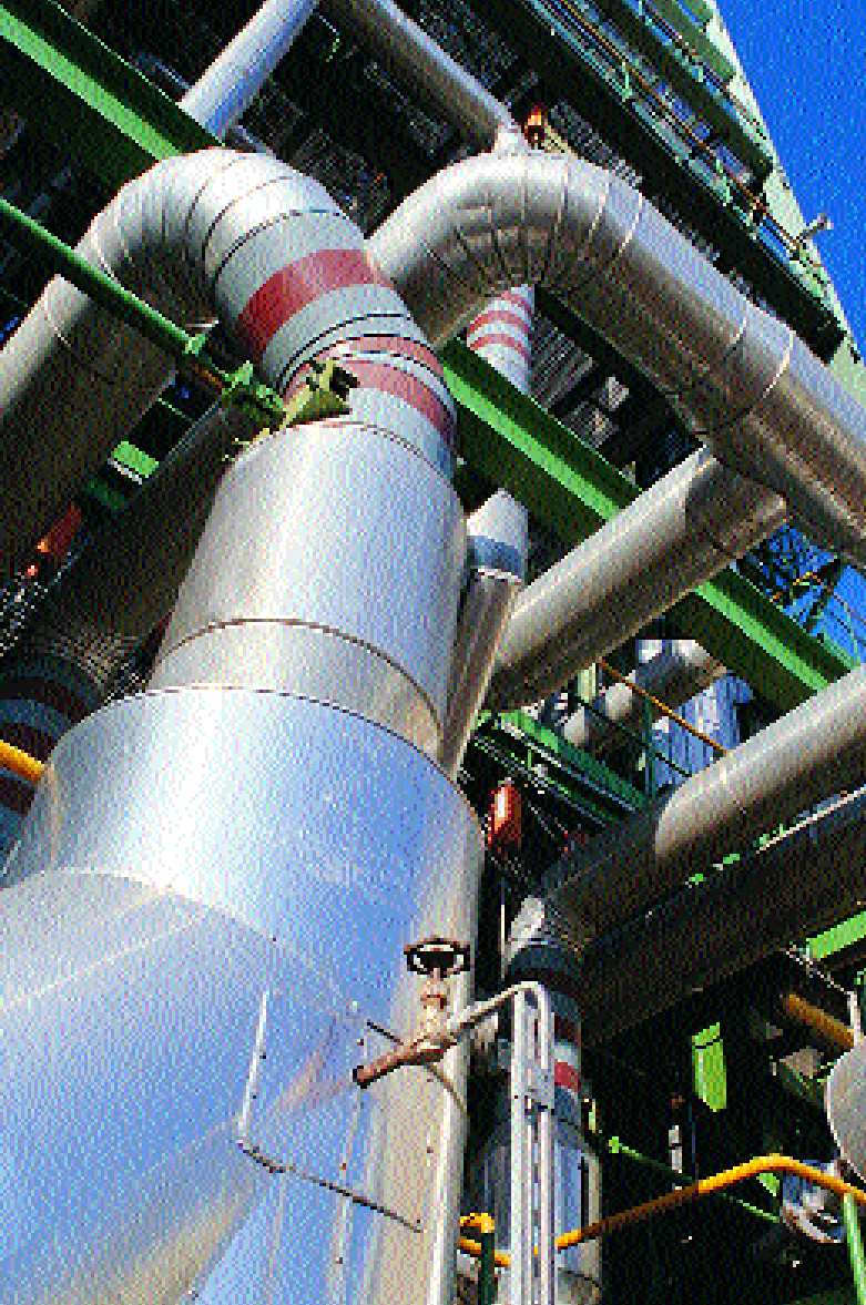
Centrale Tor di Valle
