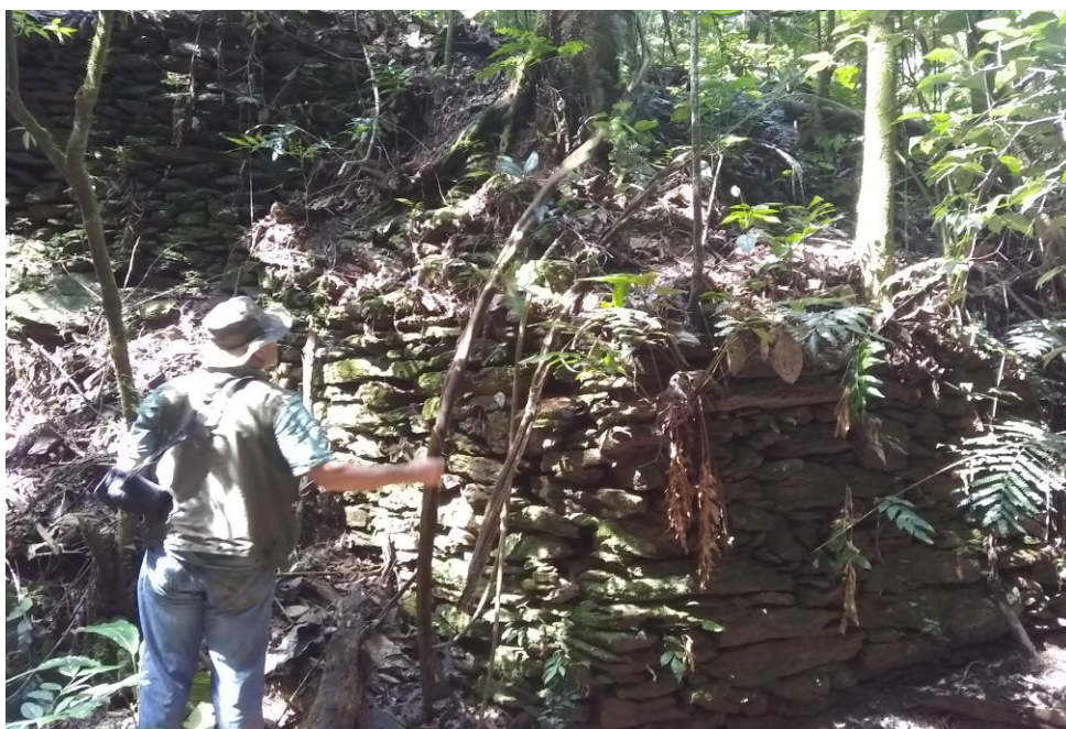
Foto nº 4b.07 - Contenção de encosta constituída de pedras secas, próximo à barragem do reservatório Ururuquara.
