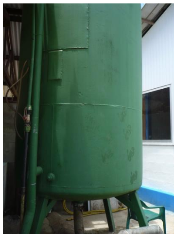
Figure 97 : photographie de la cuve d'eau incendie présent sur site
