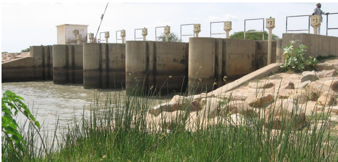
Figure 8 : Vannes du barrage de Maga s'ouvrant sur le Mayo Vrick
