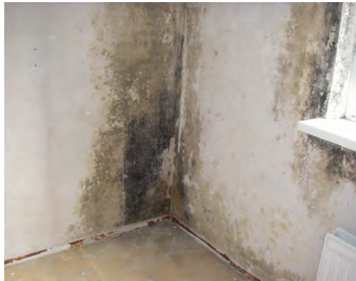
Schimmelpilz in Altbau
