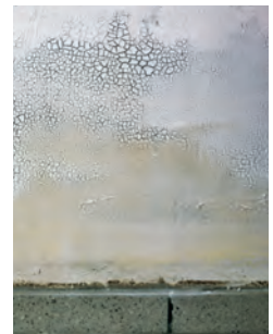
Der Entöler mit den gelösten Verschmutzungen trocknet krustenartig aus
