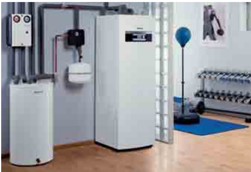
Eine moderne Heizungsanlage ist Voraussetzung für echte CO 2 -Fitness.
