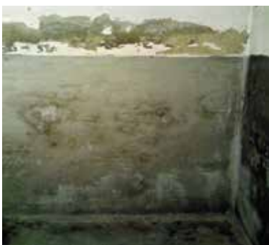
Falsche Abdichtungsmethode. Der Wasserschaden wurde lediglich hinter einem Spezialputz versteckt. Das Wasser dringt weiterhin ins Mauerwerk ein und überwandert den Spezialputz innerhalb 1-2 Jahren.
