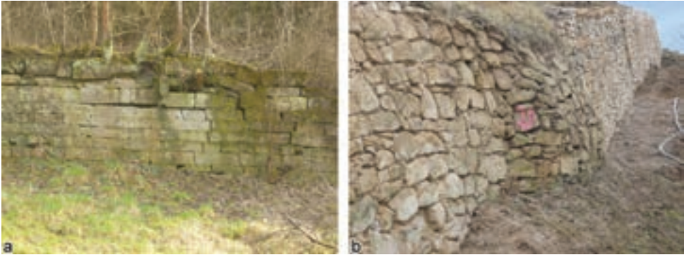
Abb. 7.6: Schäden durch Gehölze (a), stark ausgeprägter Mauerbauch (b)
