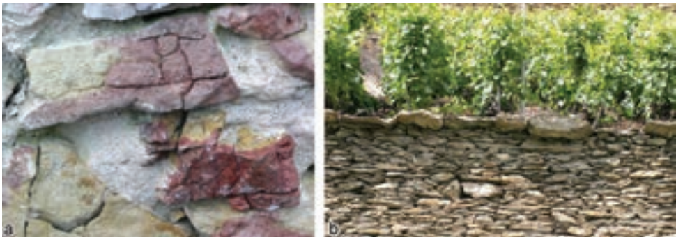
Abb. 7.5: Alte Schäden durch Feuer an den Steinen einer Mauer, die jüngst durch technisierte Verfahren saniert wurde (a), verschobene Mauerkronensteine (b)
