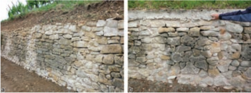
Abb. 7.9: „Verfugungsgerüst“ an Mauern (b mit historischer Betonkrone)
