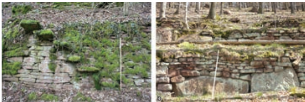
Abb. 5.3: Kragstentreppe im Plattensandstein (Obrigheim-Mörtelstein, a), große polygonale Steine in den Trockenmauern deuten auf lokal anstehendes Gestein hin (Klingenberg am Main, b)
