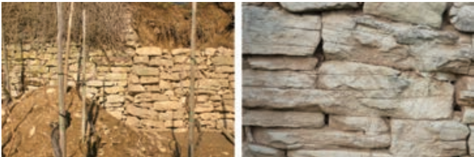
Abb. 7.4: Mangelhafte Reparatur durch fehlende Verzahnung mit dem Altbestand (a) und starke Verwitterungserscheinungen (b)
