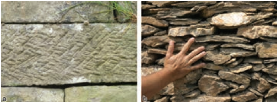
Abb. 3.1: Trockenmauer aus Schilfsandsteinen mit stark bearbeiteten Oberflächen (Stetten im Remstal, a), Mauer aus schieferartigem Gestein (Wallis, b)
