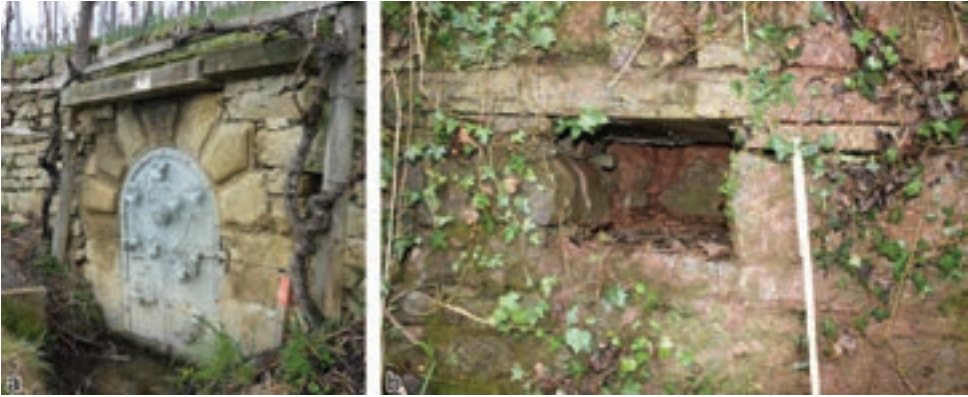
Abb. 3.28: Unterschiedliche Quellfassungen (Vaihingen/Enz-Enzweiingen, a, und Obrigheim-Mörtelstein, b)
