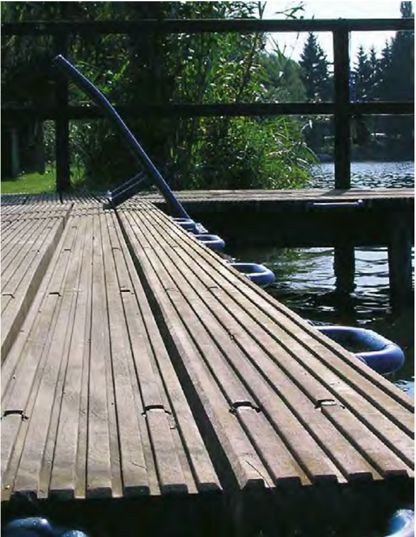
Unterkonstruktion im Wasser: Anwendungsbeispiel für Bongossi-Kantholz
