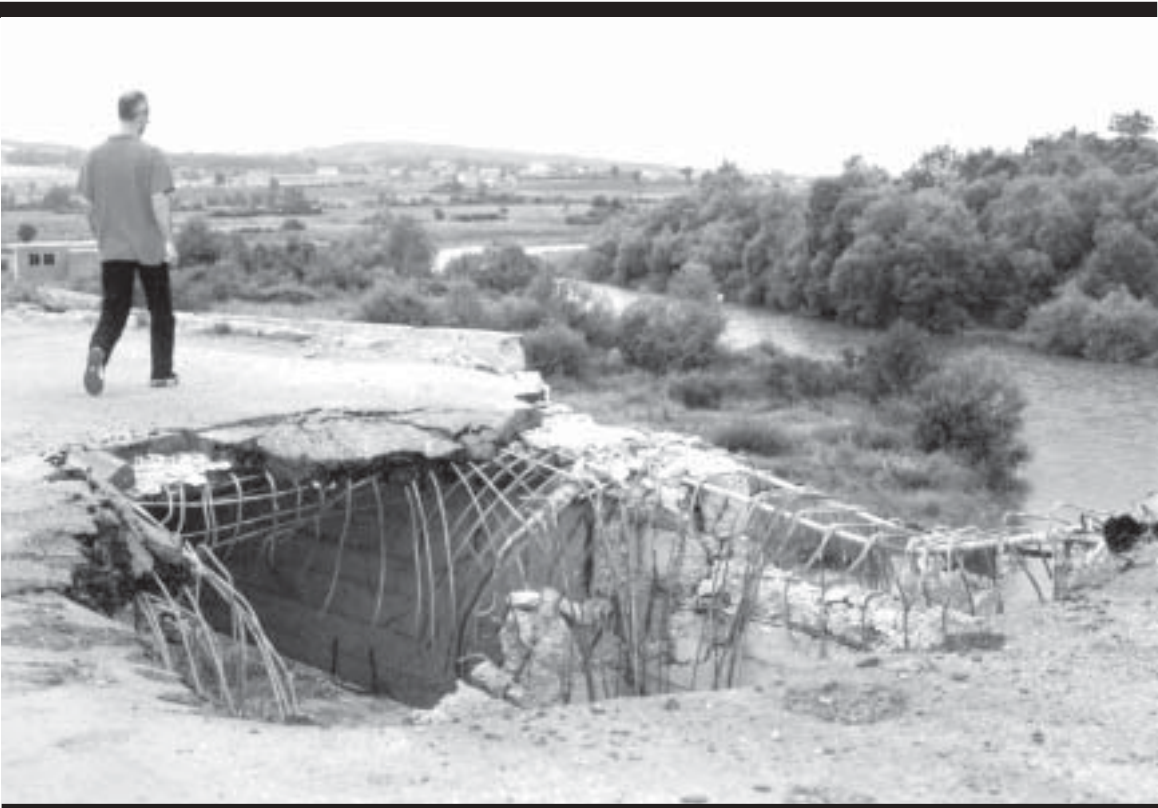
Dëmtime të shkaktuara nga bombardimet e NATO-s përgjatë autostradës Prishtinë-Pejë.
