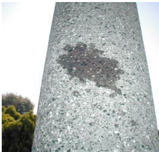
Figura 4. Mancha focalizada a un mínimo de 2 metros sobre el suelo, fuera del alcance de los niños.
