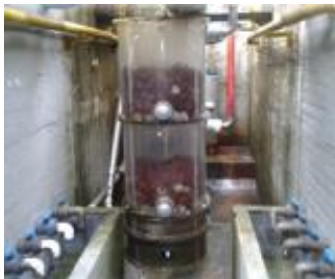
BIOFILTRO Depuración Biológica del H 2 S
