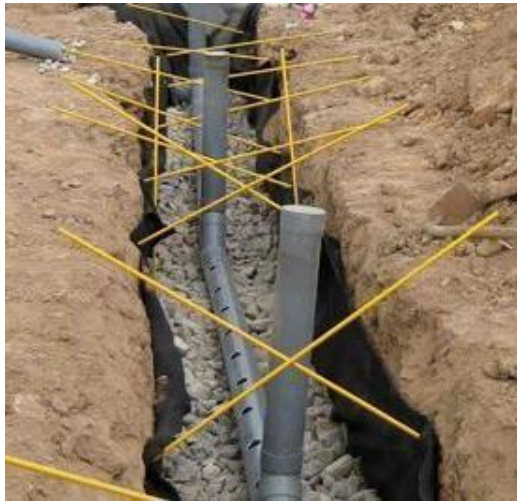
Campos de Infiltración
