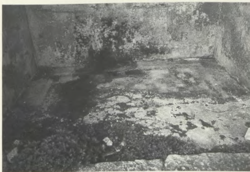
3. Lo stato di conservazione del mosaico della taberna 8 nel 2002 con evidenti fenomeni di risalita d'acqua (M. Vitti).
