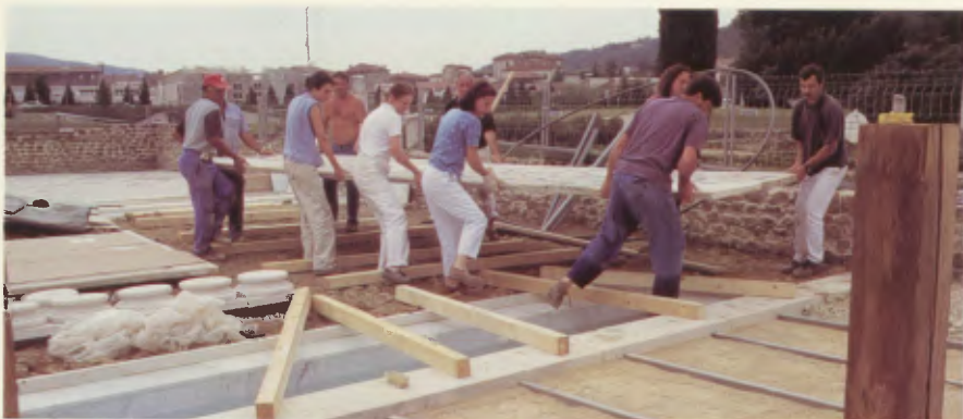
4. Mise en place des panneaux de mosaïque sur des tubes métalliques (péristyle).
