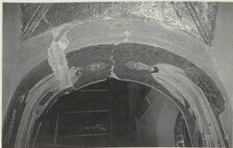
1. Κατάρρευση τμήματος και ρηγμάτωση στο ΝΔ τόξο.
