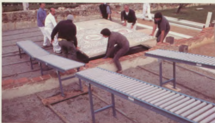
6. Manutention des panneaux de mosaïque à l'aide de chemins de roulement modulaires.
