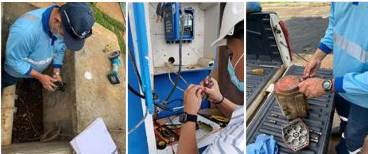
Personal de electromecánica brinda mantenimiento a los macro medidores y equipos de laboratorio y plantas potabilizadoras.
