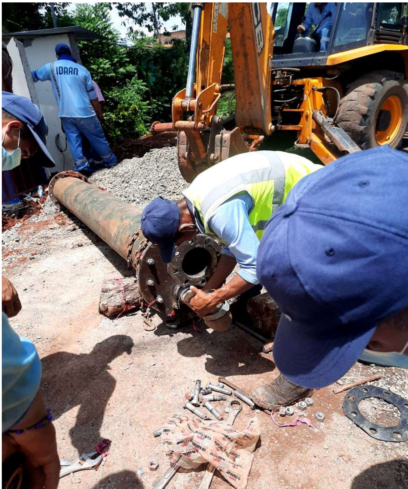
Rehabilitación de Estación de bombeo de Bianchery con mejoras al suministro de agua potable en Chorritos 3, Santa Librada y parte de Sector Amaya en el Corregimiento El Coco, Distrito de La Chorrera.
