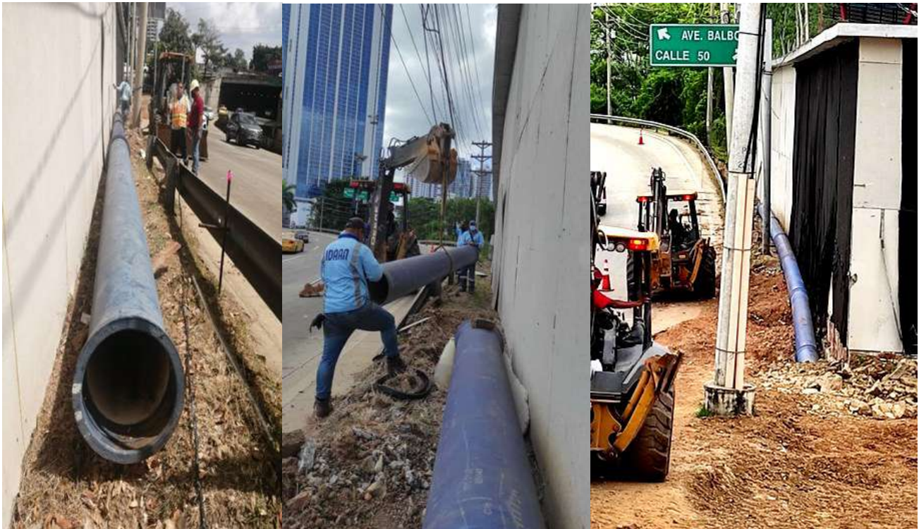
Interconexión línea de 16" a un costado del Corredor Sur.
