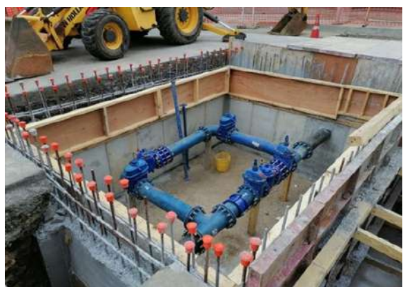
Caja de interconexión No.4 en calle 74 San Francisco.
