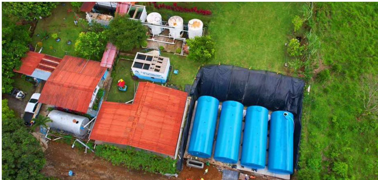
Tanques de reserva de la Planta Potabilizadora de San Francisco / San Andrés, Bugaba.
