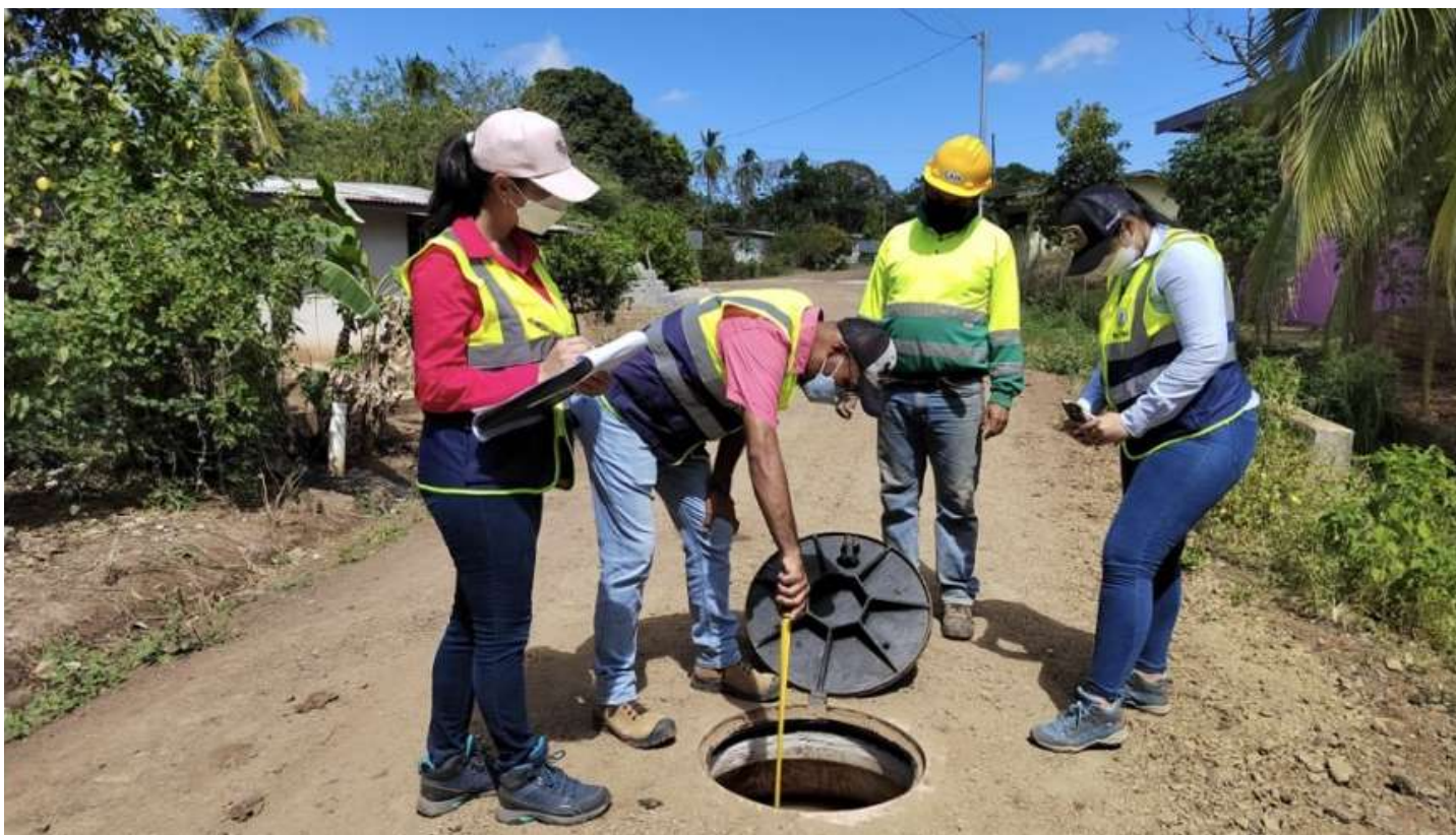
Pruebas de fuga y alineamiento en el proyecto de construcción del sistema de alcantarillado sanitario de Paritilla.
