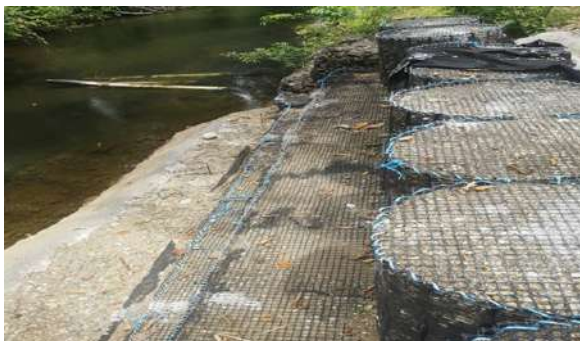
Muro de Gaviones para reforzamiento de Talúd. PTAP de El Real, Darién.
