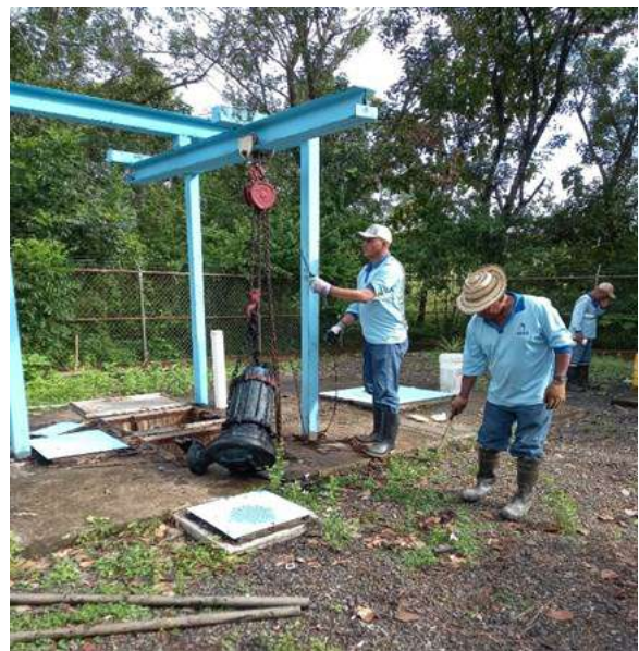
Mantenimiento a EBARS.
