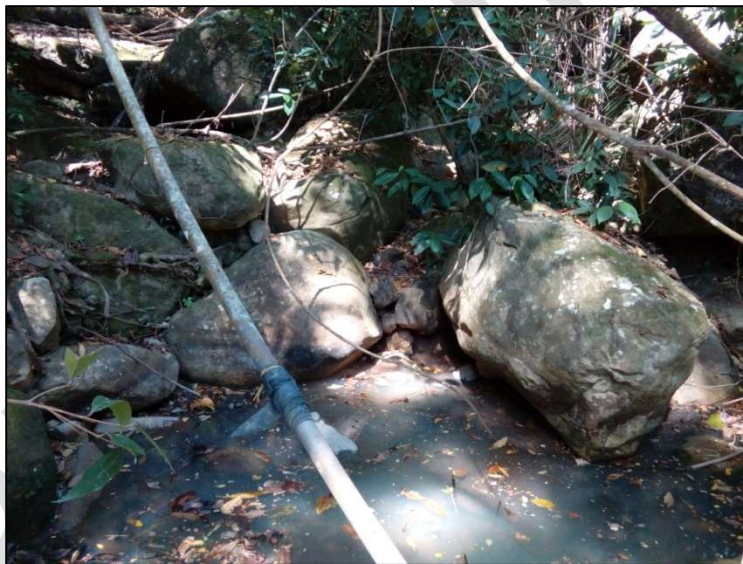
Fotografía 36 Captación de agua de la quebrada La Palmichala. Fuente: INGETEC. Presente estudio
