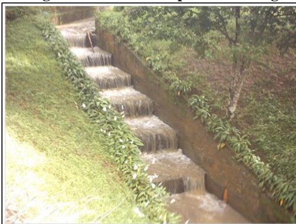
Fotografía 2-18 Disipador de energía
