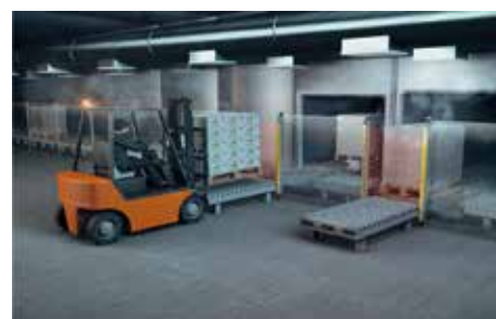
Bild 3: SPG erlaubt eine sehr kompakte Systemanordnung bei Materialschleusen
