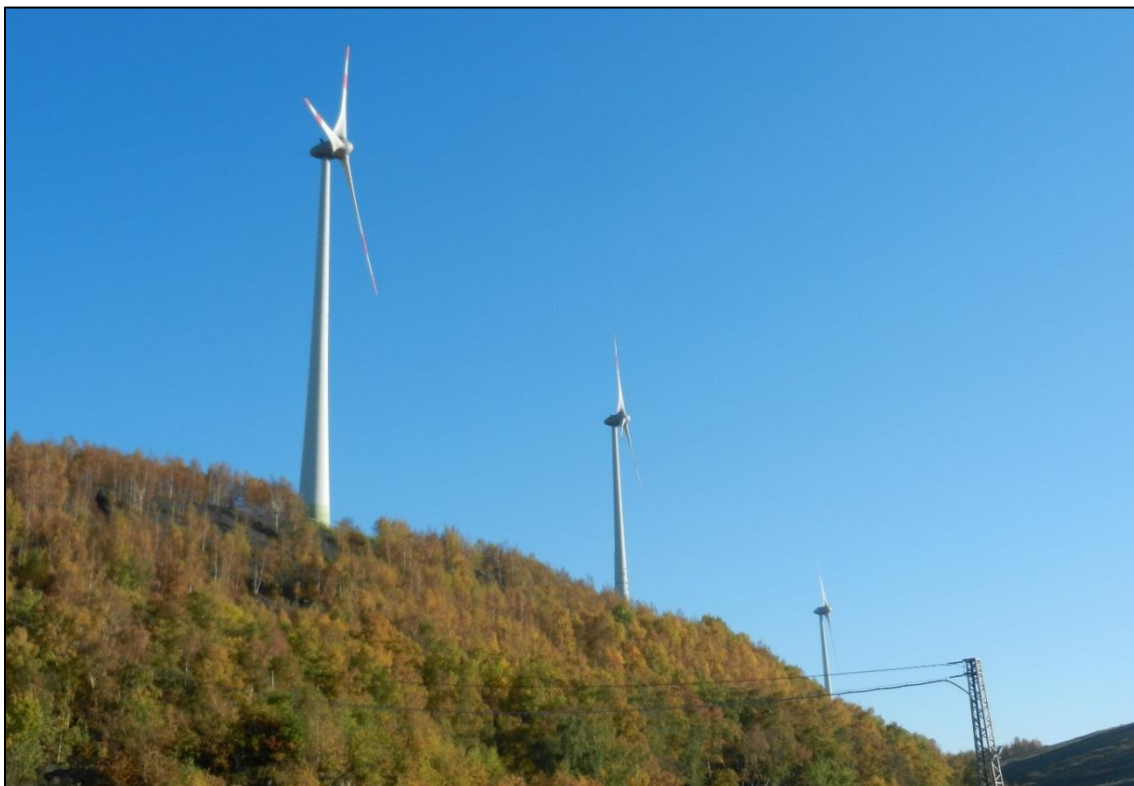
Abbildung 11: Windenergieanlagen auf dem Piesberg (nördl. von Osnabrück) (Foto: U. Gehrlein)
