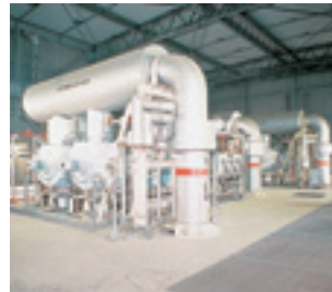
LNG reciprocating compressors
