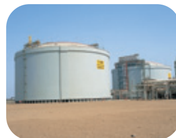
LNG receiving Terminal
