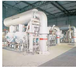
LNG reciprocating compressors
