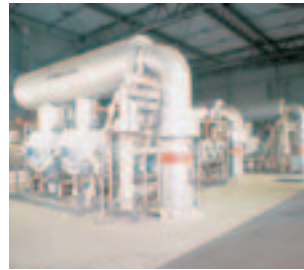
LNG reciprocating compressors
