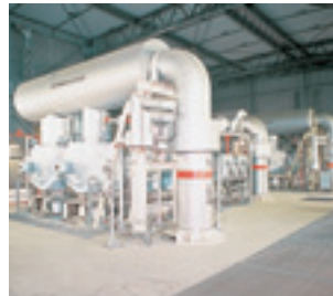
LNG reciprocating compressors
