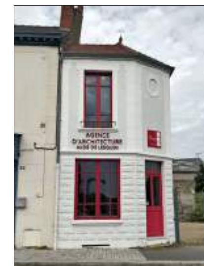
Fig. 387 : Enduit hydraulique/couleur peu adaptée
