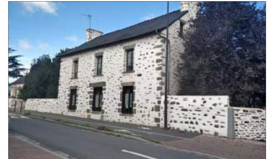
Fig. 386 : Mauvaise mise en œuvre de l'enduit à pierres vues
