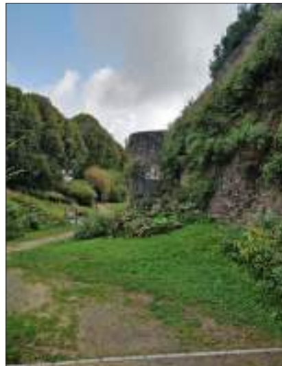
Fig. 377 : Végétation en pied de rempart, Promenade des remparts Jules Revert
