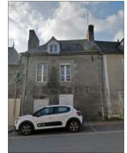
Fig. 385 : Enduit hydraulique et parasitage biologique
