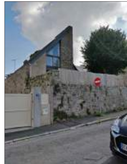
Fig. 378 : Végétation de disjoints de murs de clôture, Rues Gilles Teze
