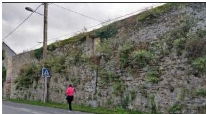
Fig. 379 : Végétation importante sur mur d'une ruine, Rue des Murets
