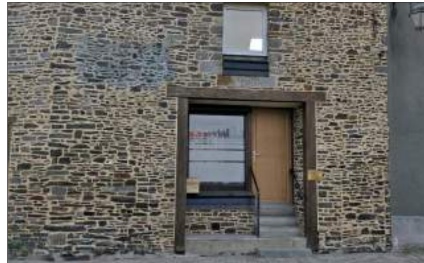
Fig. 383 : Façade remaniée/Ouverture de baie non respectueuse de la composition
