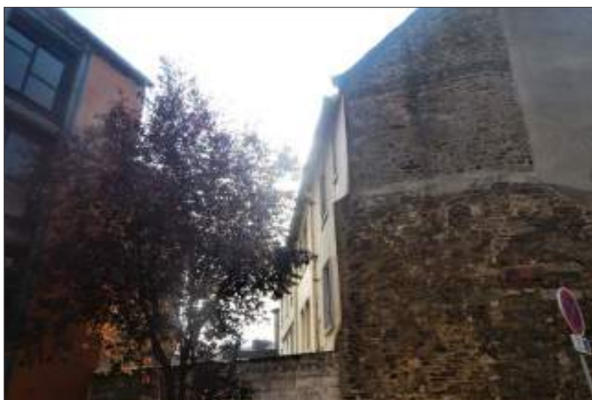
Fig. 190 : Coup de sabre témoignant d'une surélévation, place Toullier
