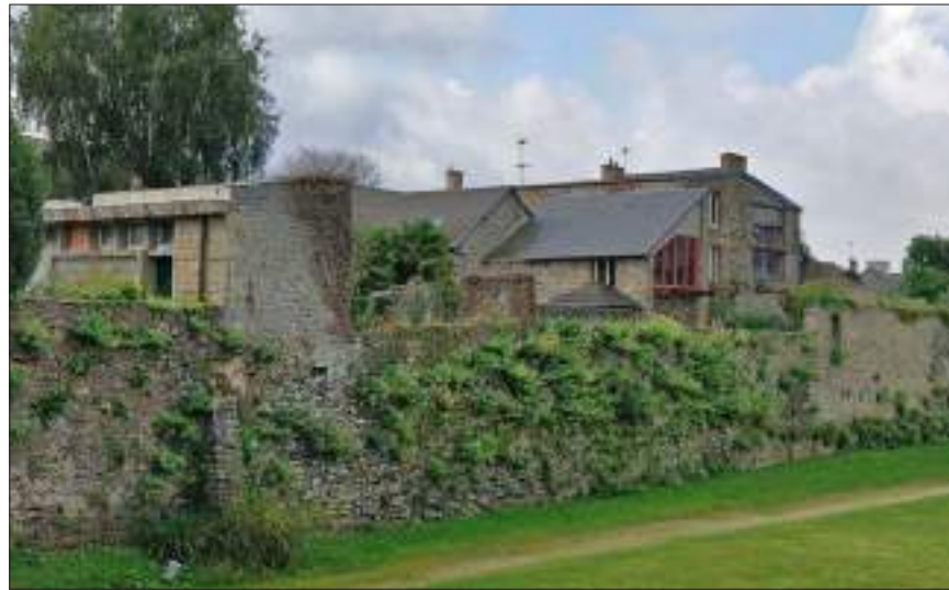
Fig. 376 : Végétation importante sur le mur de rempart, Promenade des remparts Jules Revert
