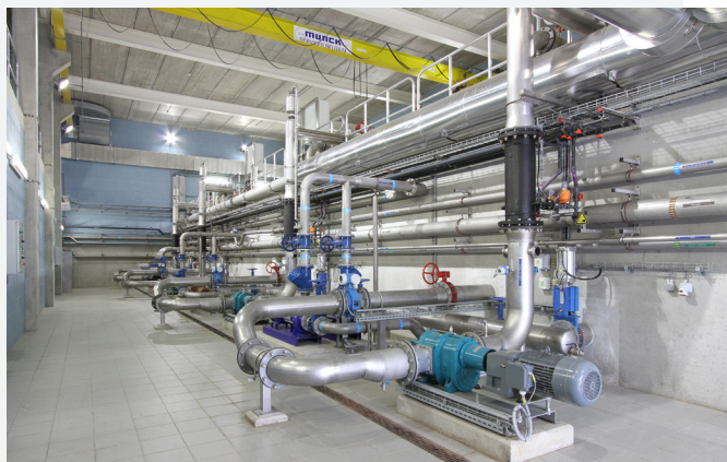
Le local des pompes des unités membranaires
