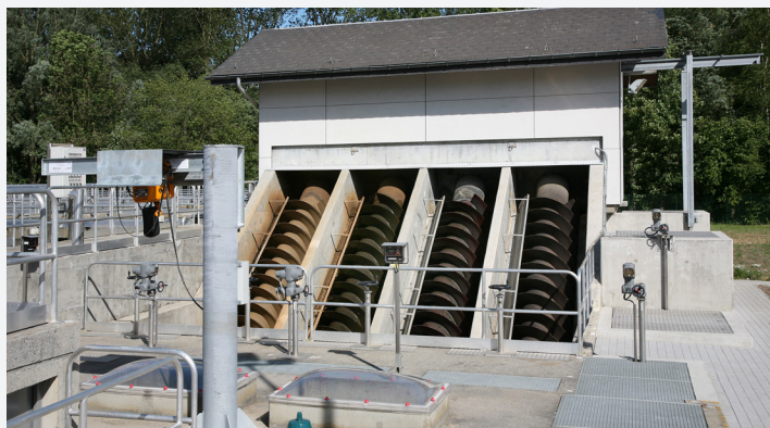
Les vis d'Archimède de relevage secondaire
