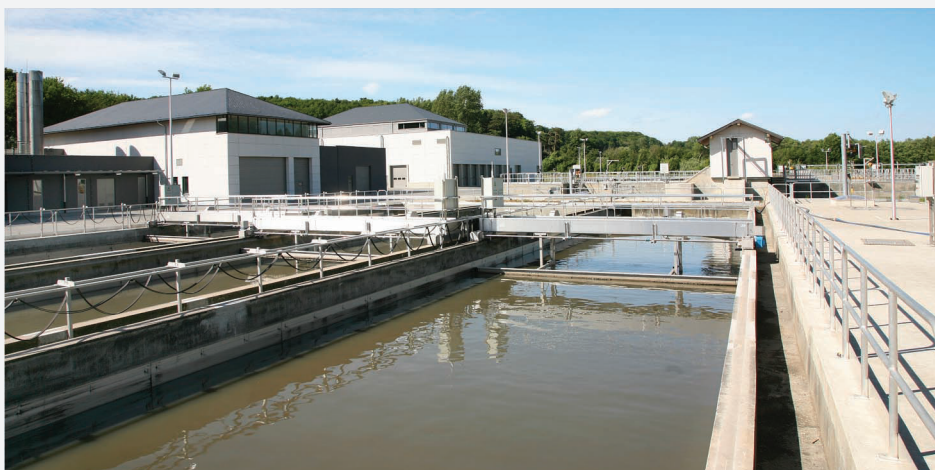
Les décanteurs primaires
