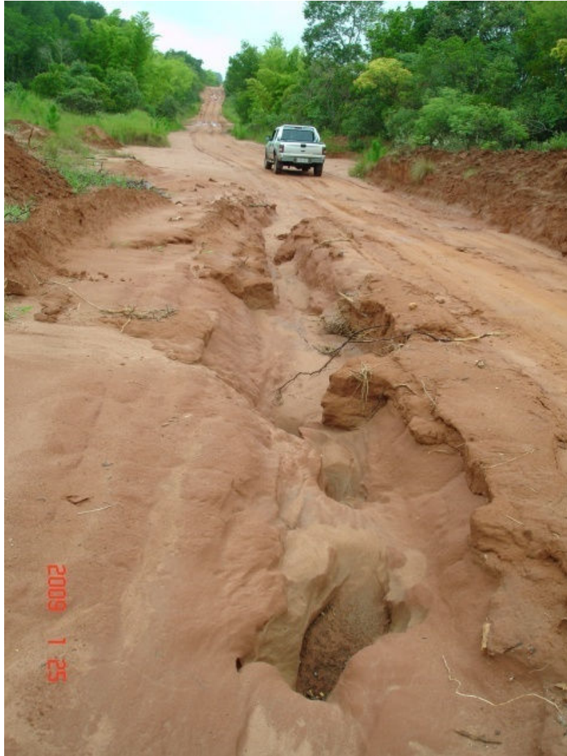
SP-261: Erosão no leito da estrada (Foto: Giselda Durigan)
