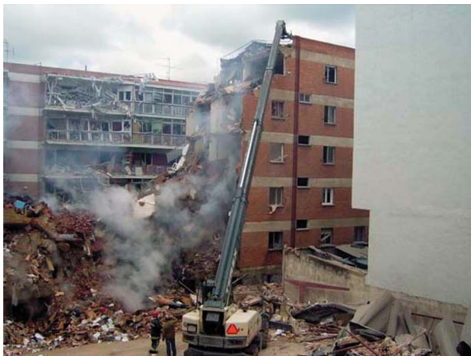
Explosión de gas natural en la calle Gaspar Arroyo, de Palencia.
