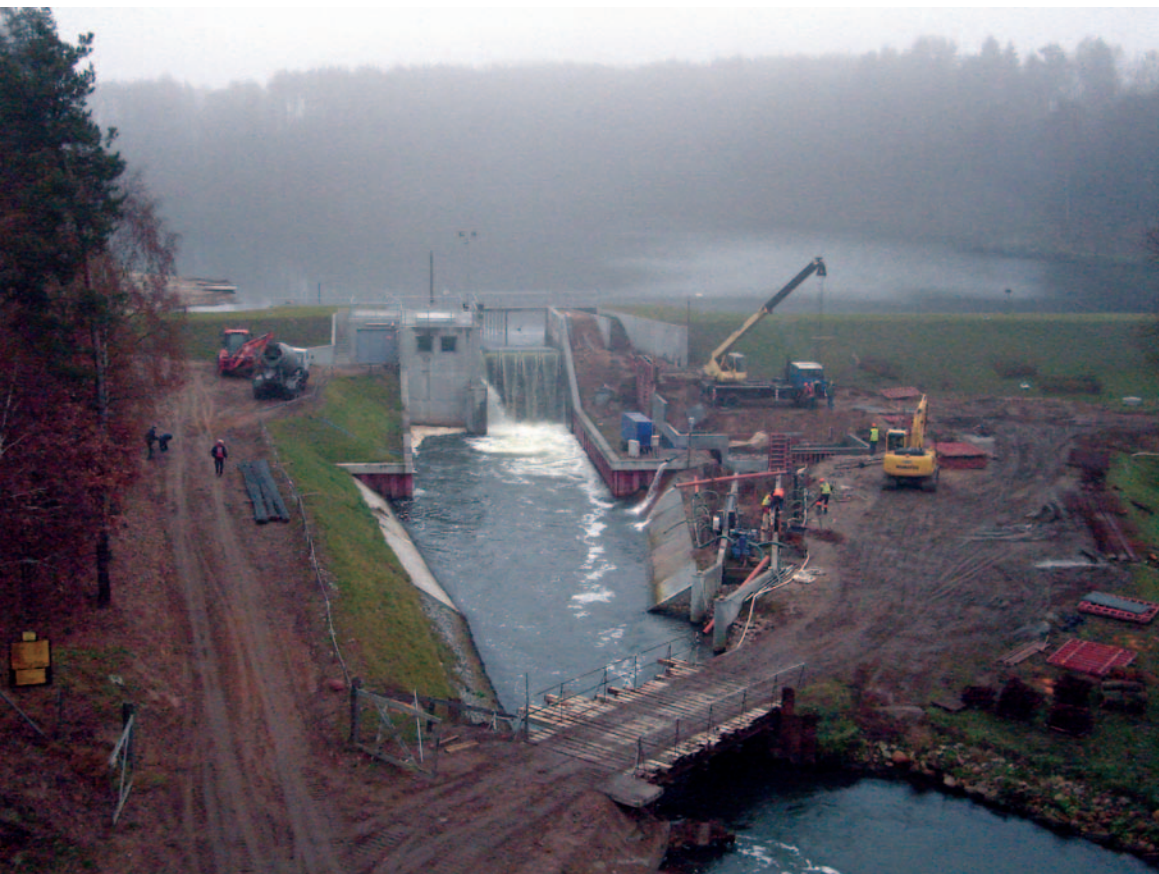
Ryc. 1. Nowo wybudowana elektrownia wodna na Wierzycy w Nowej Wsi Rzecznej (obszar Natura 2000 – PLH 220094 „Dolina Wierzyca”, 19.11.2011 r.; fot. G. Radtke)
