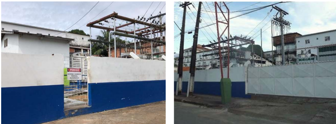
Figura 125: Subestação de energia elétrica de Silves/AM.
