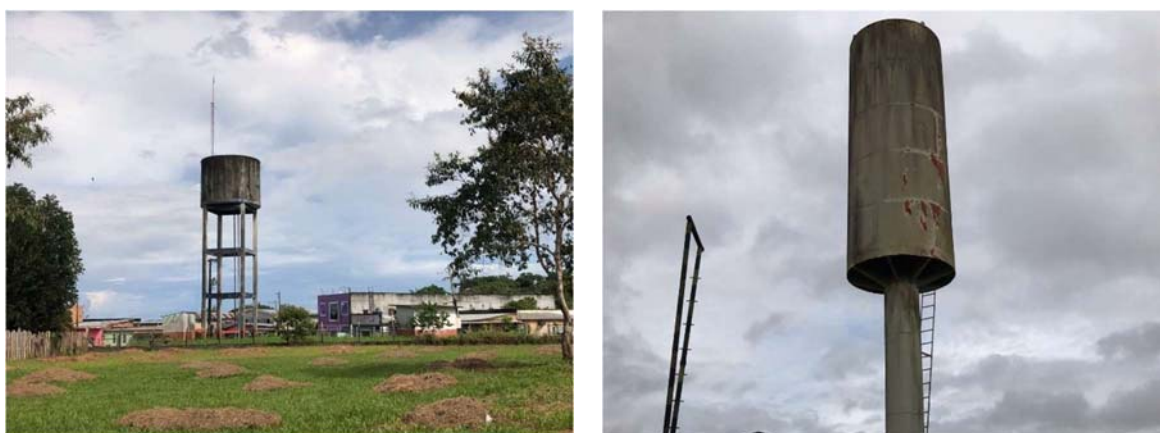
Figura 123: Caixa d'água elevada no município de Itapiranga e Silves/AM, respectivamente.
