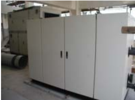
图 6 高效、环保、健康新型空调系统
