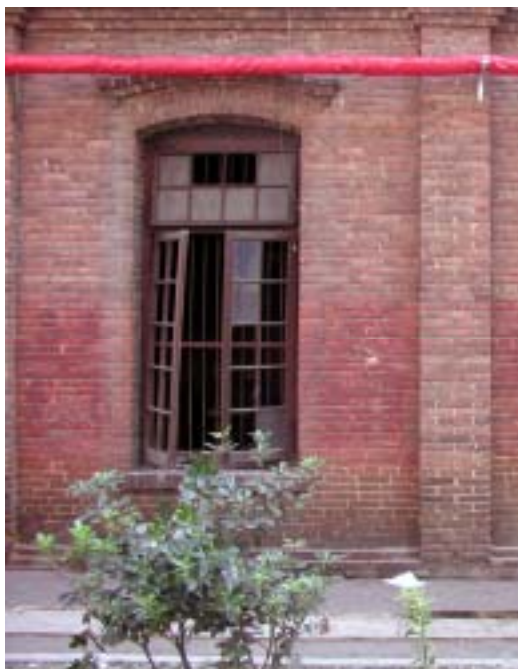
原有建筑已破损不堪
