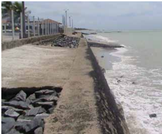
Figura 16 - Muro para contenção do processo erosivo. Itamaracá, litoral norte.
