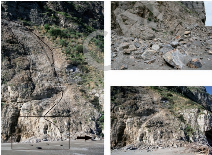
Fig. 127 – Fenomeni di instabilità lungo il versante orientale del promontorio di Tindari (foto C. Martino).
