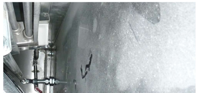
Vista interior de un plenum de extracción con lámparas UV-C tras varias semanas de uso.
