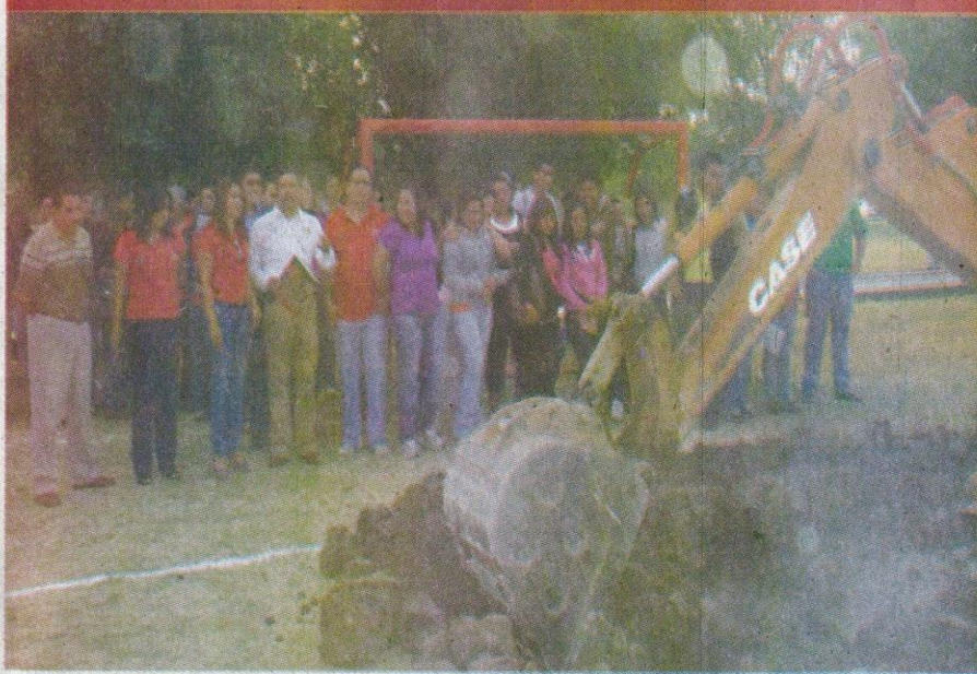
El titular de la Oficina de Servicios Federales de Apoyo a la Educación en el estado de Guerrero, César Quevedo Inzunza, dio inicio a los trabajos de construcción del centro de cómputo en el Instituto Tecnológico de Iguala.
