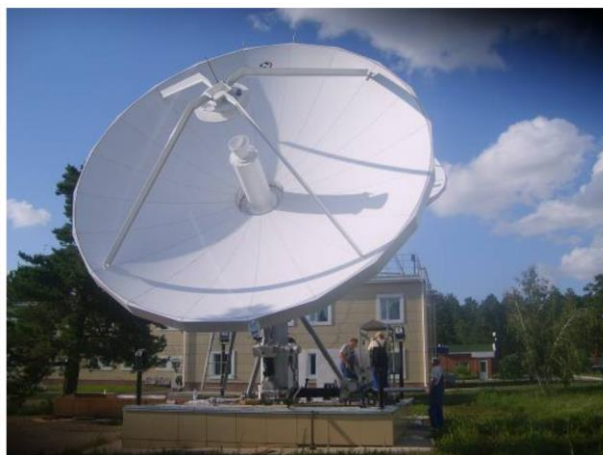
Sistema de antena de 7,3 m
