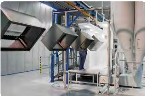
Spritzautomat der Pulverlackiererei
