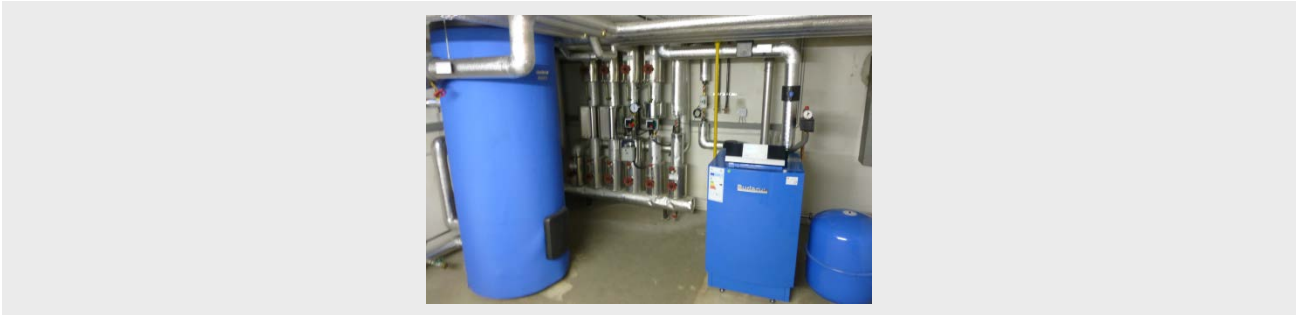
Bild 37: Gebäude und Wärmeversorgungsanlage 500-H109
