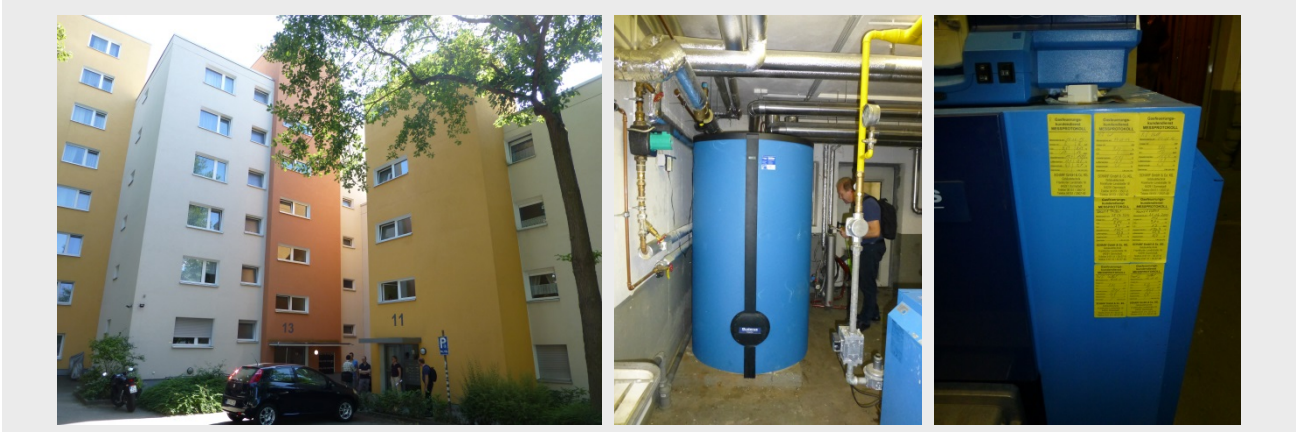
Bild 9: Gebäude und Wärmeversorgungsanlage 500-H053
