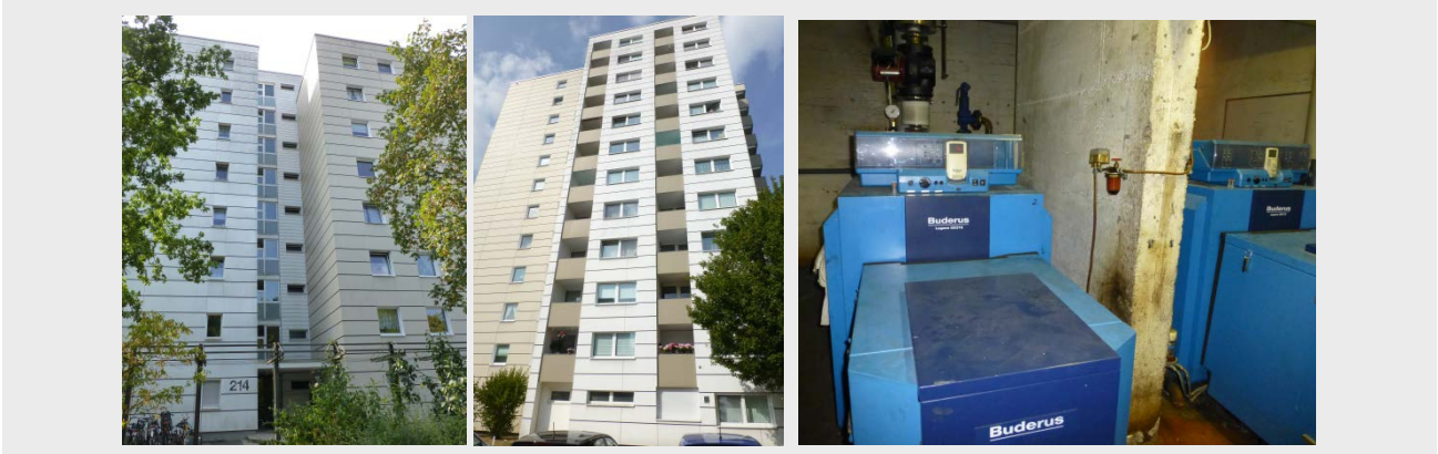
Bild 14: Gebäude und Wärmeversorgungsanlage 500-H126
