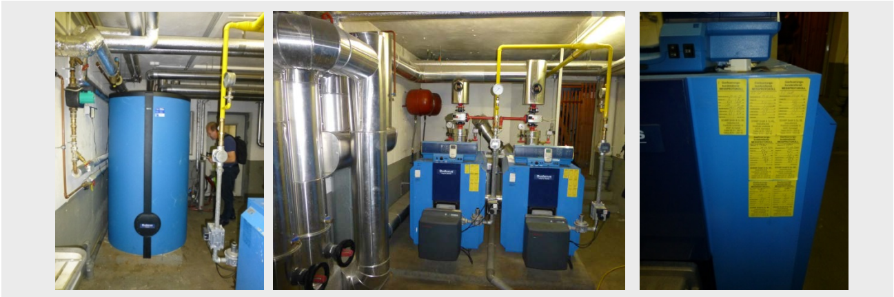
Bild 57: Gebäude und Wärmeversorgungsanlage 500-H053
