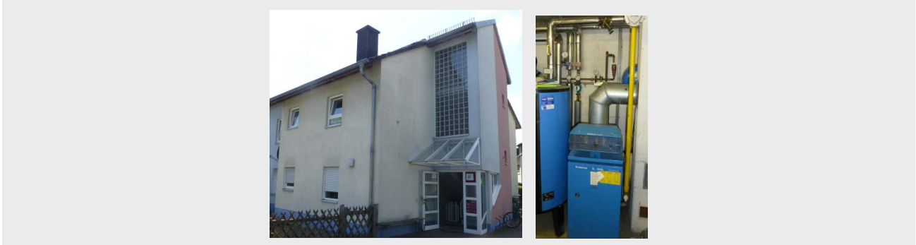
Bild 11: Gebäude und Wärmeversorgungsanlage 500-H65
