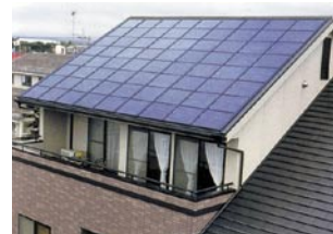
Solar cell module
