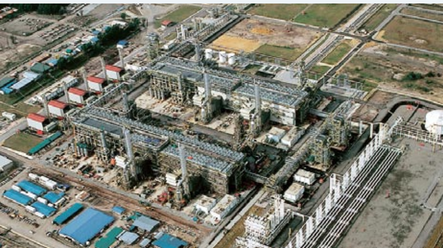
LNG plant, Malaysia
