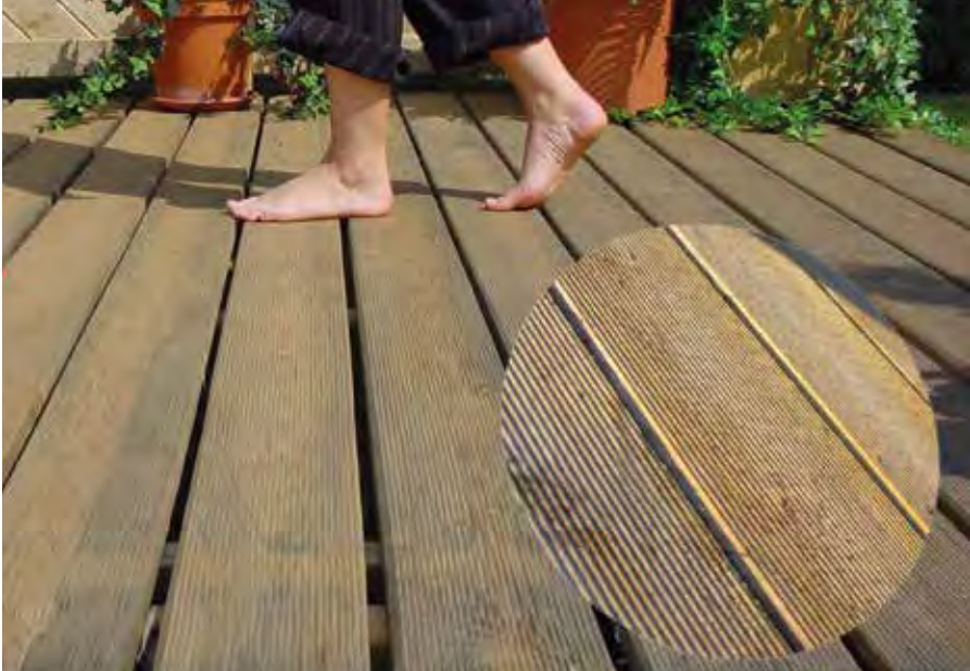
Holzdeck aus Kiefer-Konstruktionsholz: angenehm von der Sonne gewärmtes Holz
