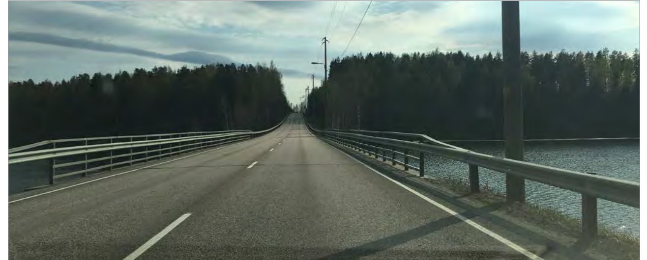
Kuva 4-3. Joutsansalmen kohdalla nykyinen silta voidaan säilyttää liikenteellä viereen rakennettavan uuden sillan rakentamisen aikana.
