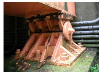
図-87 固定支承のセットボルトの破断
