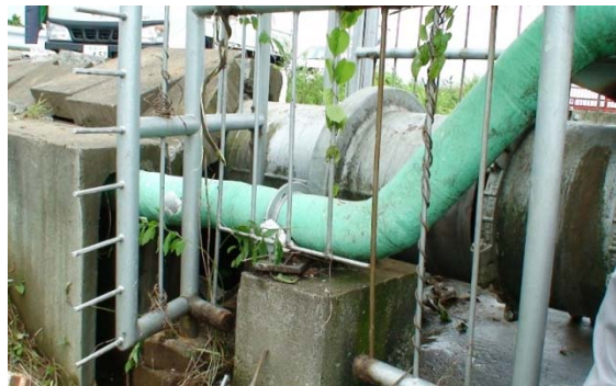
図-60 六識橋左岸の盛土沈下による側溝の損傷
