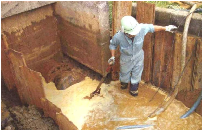
図-77 八坂中継ポンプ場の圧送管漏水 (引用：日本下水道新聞)
