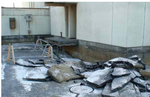
図-75 八坂中継ポンプ場内の地盤沈下
