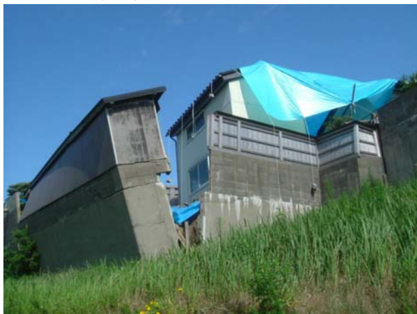
図-137 擁壁の倒壊 (上部は木製の扉) (中浜1丁目)
