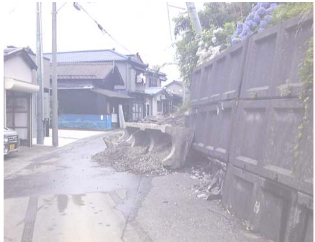
図-136 大型ブロック擁壁倒壊 (西本町1丁目)
