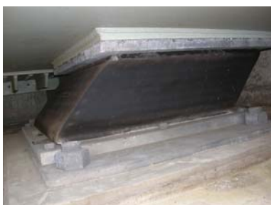
図-97 ゴム支承の変形
