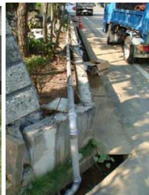
図-63 松波町の地上仮設配管
