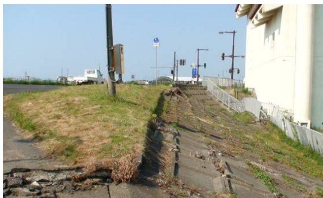
図-76 八坂中継ポンプ場裏の盛土のすべり
