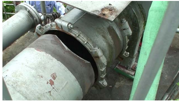
図-61 六識橋左岸の鋼管継手の抜け
