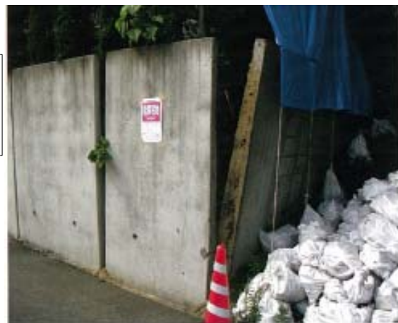
図-143 宅地擁壁の被災度判定状況 (判定結果ステッカー表示)
