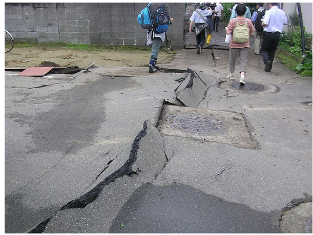
図-19 砂丘麓部分の圧縮痕 撮影場所：(37.367855,138.54487)
