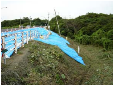
(b)盛土のり面の被災状況
