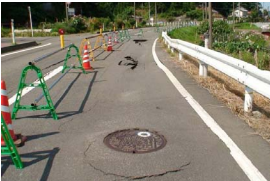
図-82 出雲崎市の下水道管きょ上の地盤沈下
