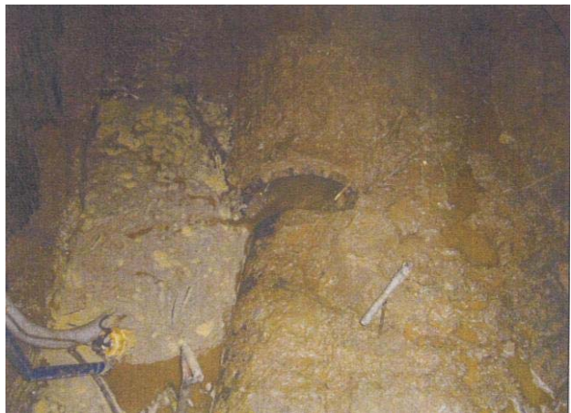
図-57 導水管(5拵・DIP(K)φ600の抜け) (新潟市水道局撮影)
