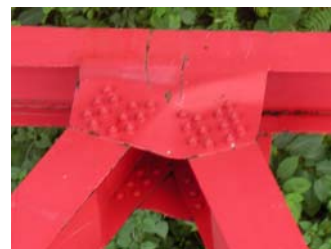
図-91 アーチ部下横構のガセットプレートの座屈変形
