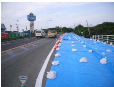
(a)路面の被災状況
