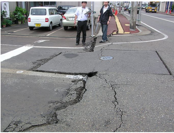
図-18 馬の背状の砂丘肩部分に現れた亀裂開口 撮影場所：(37.367019,138.546063)
