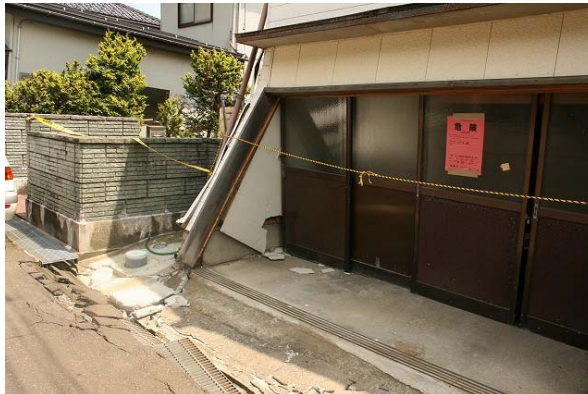
図-36 液状化に伴う地すべりの滑落崖上の家屋被害(山本団地)
