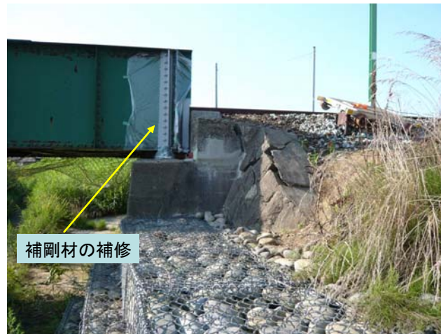
図-125 鯖石川橋梁の損傷
