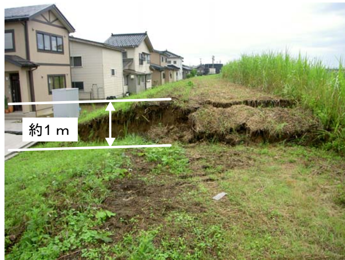
図-42 陥没した鯖石川左岸堤防 (橋場町)
