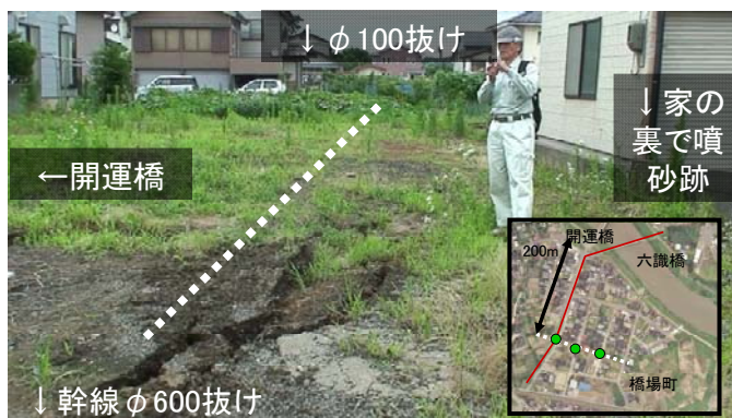
図-62 橋場町の地盤流動による亀裂
