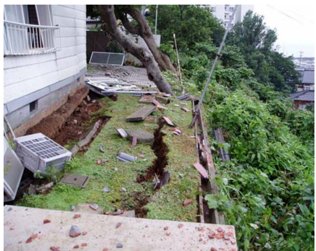
図-140 斜面天端の盛土部分の滑動 (東の輪地区)
