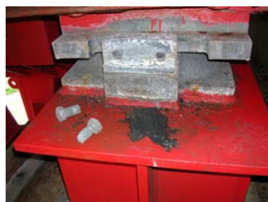
(a)アップリフト止めの損傷
