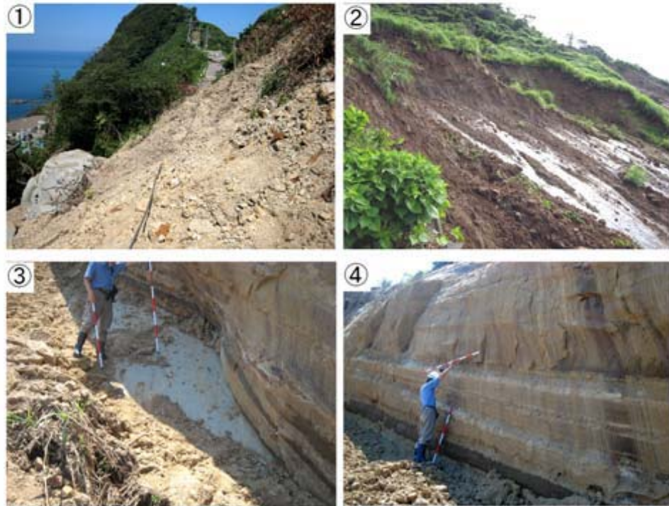
図-50 聖ヶ鼻の崩壊写真
