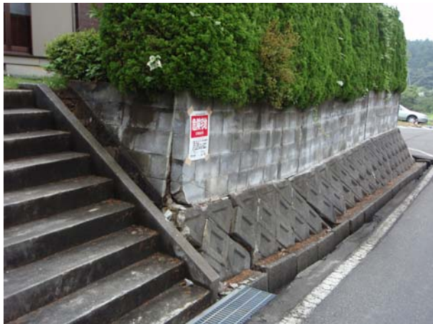
図-135 石積擁壁の亀裂と建築ブロックの倒壊 (朝日ヶ丘団地)
