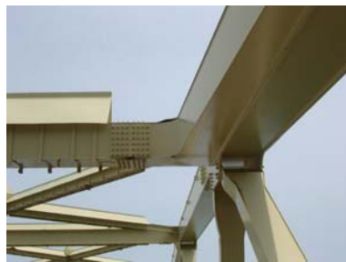
図-86 橋門構隅角部の溶接部の座屈変形と割れ
