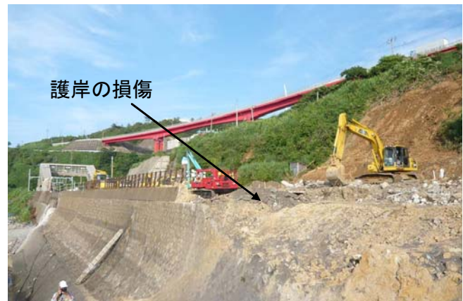
図-120 青海川駅構内の護岸の損傷
