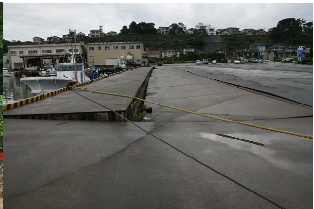
図-41 傾斜したケーソン岸壁 (柏崎港)
