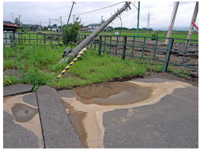
図-122 荒浜駅駐車場の噴砂
