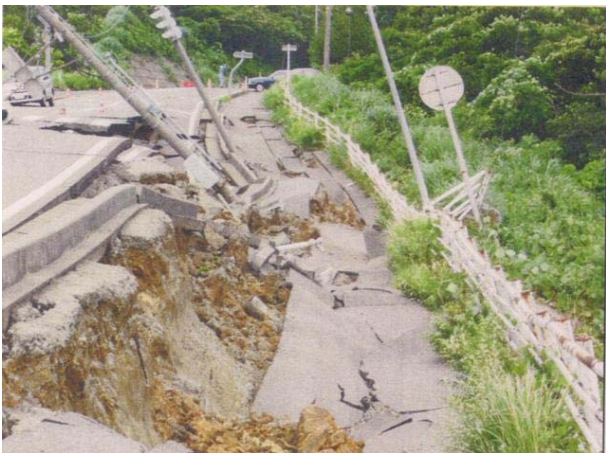
図-56 国道8号線盛土崩壊状況 (新潟市水道局撮影)
