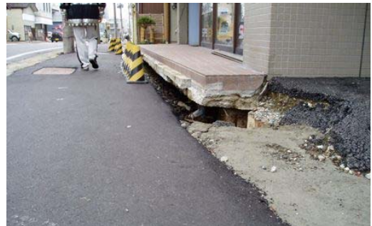
図-67 地質境界付近の地盤状況 (復旧後)
