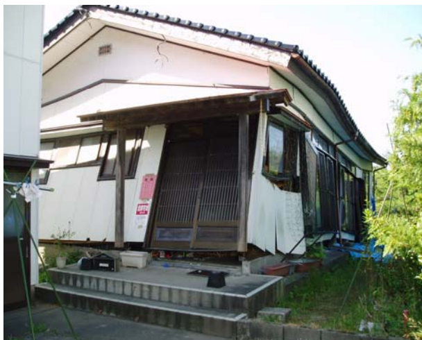
図-139 盛土部分の滑動崩落により家屋の倒壊 (西山町中央台地区)
