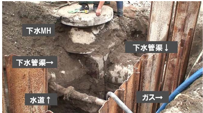
図-79 八坂中継ポンプ場の管路漏水
