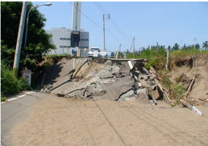
図-64 クリーンセンター前の管路被害
