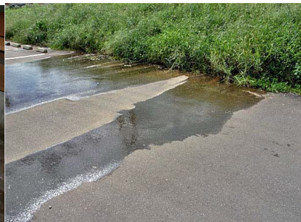
図-39 砂丘斜面（雑草部分）からの湧水（下高町、写真：保坂吉則）
