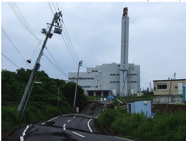
図-24 柏崎クリーンセンターと道路陥没 (37.39355,138.586307)
