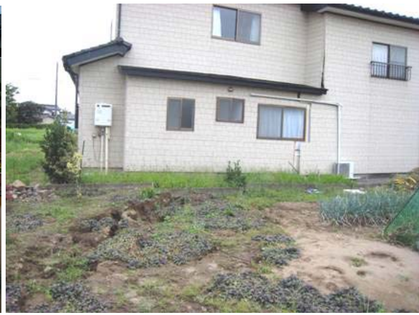
図-35 旧河道における液状化被害(橋場町)
