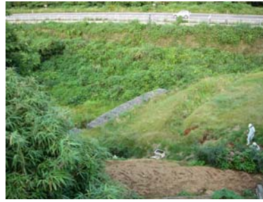
(b)盛土のり面変状状況
