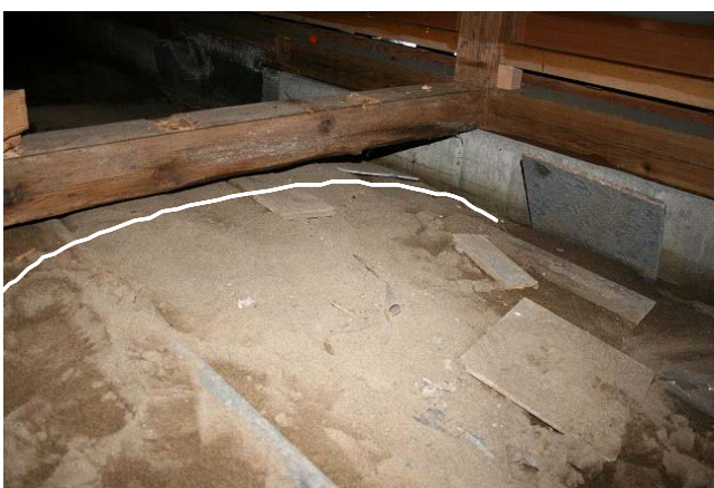
図-38 液状化による布基礎の沈下と床下地盤の盛り上がり（長崎北端）
