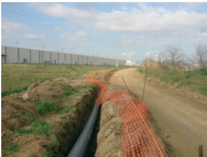
Tuberías para la conducción del agua
