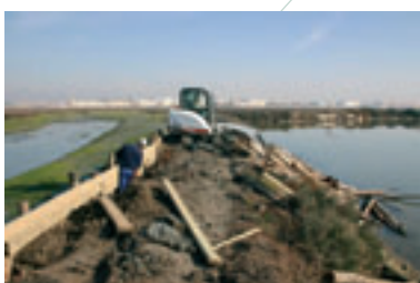
Colocación de tablestacado y reparación de vuelta de fuera en "La Covacha"
