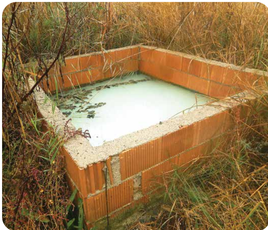
Acondicionamiento básico realizado para preservar el manantial de los antiguos Baños de Santaella. En la actualidad carecen de uso.
