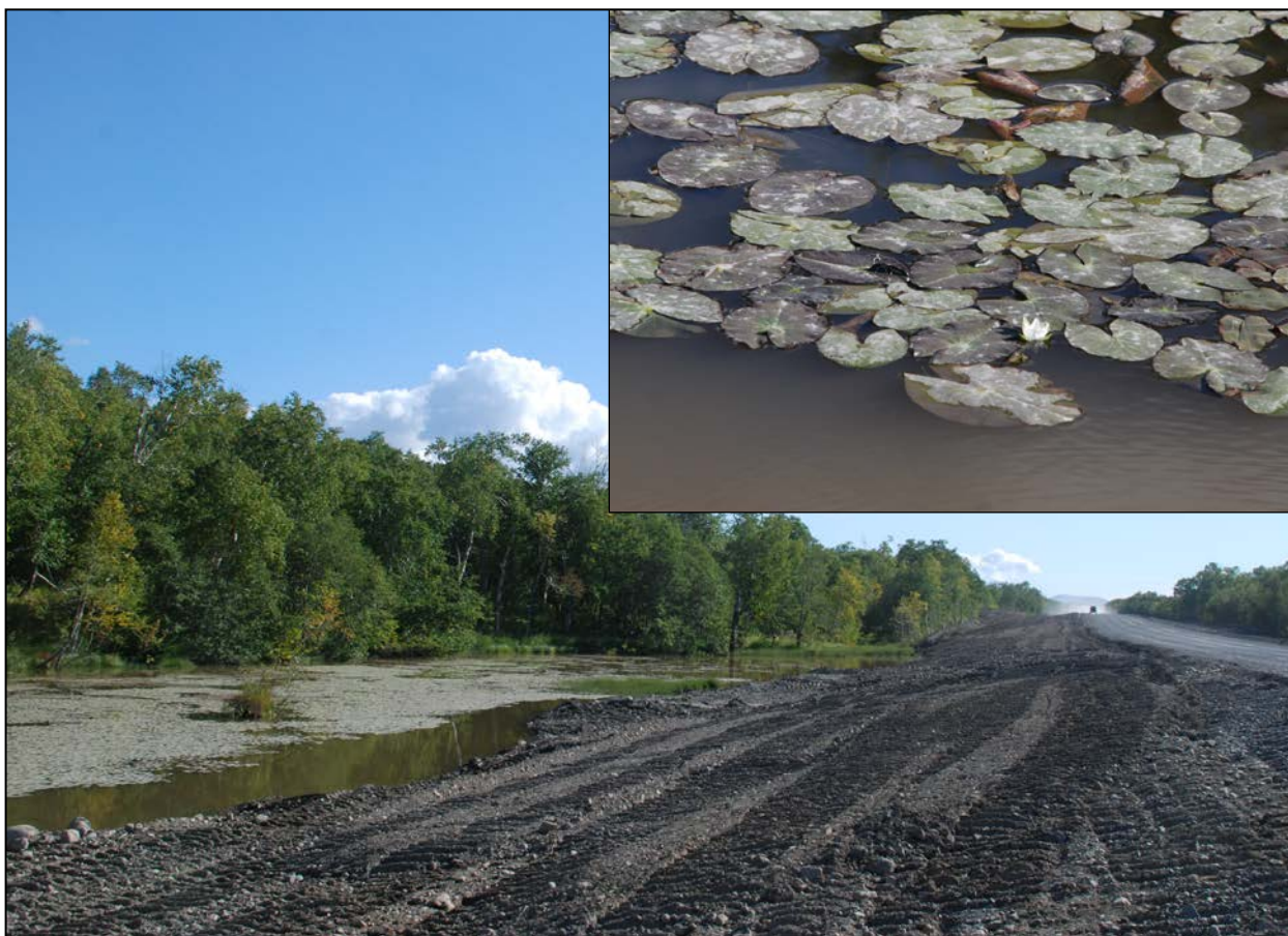
Рис. 62. Слева от дороги – водоем с популяцией редкого вида растений – кувшинки четырехгранной Nymphaea tetragona Georgi, попавшей под негативное воздействие строительства автотрассы (5 км до моста через реку Правая Камчатка).
