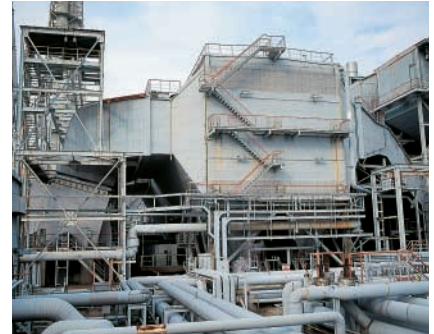
Electrostatic precipitator (Kainan Power Station)
