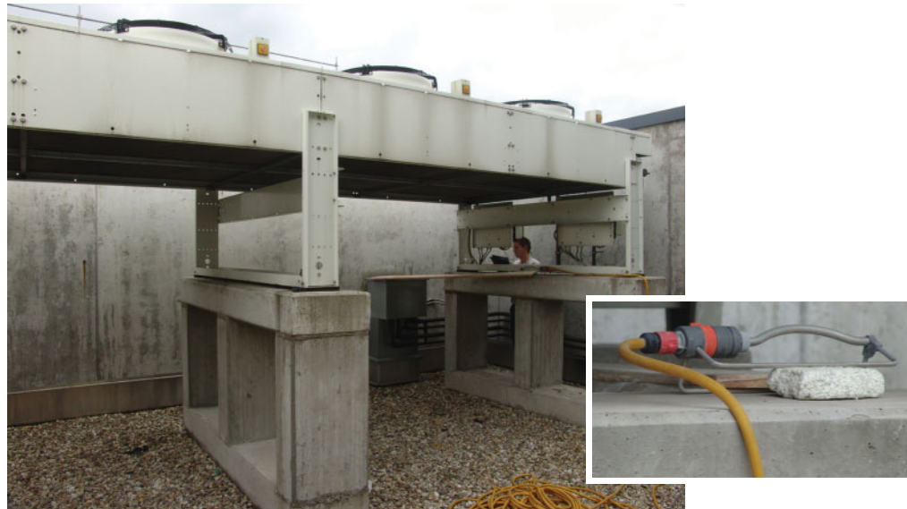
Übliche Leistungserhöhung bei falsch ausgelegten Rückkühlwerken
