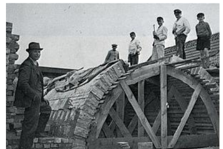
Bau eines neuen Brennofens für die Töpferei Wilhelm Erning, Stadtlohn im Jahre 1942 durch den Bauunternehmer Josef Roth, Stadtlohn, in Elling, Wilhelm: Steinzeug aus Stadtlohn und Vreden. Vreden 1994, S. 337.
