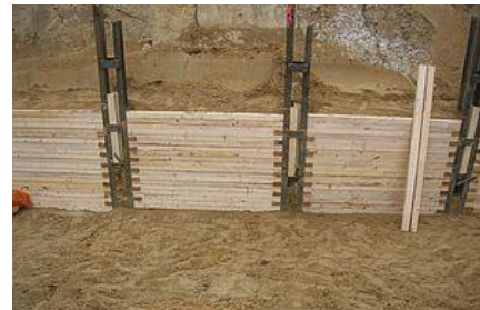
Berliner Verbau: Stahlträger und Holzbohlen sorgen dafür, dass kein Erdreich in die Baugrube rutscht. Foto: Günter Tillack, Kreis Borken
